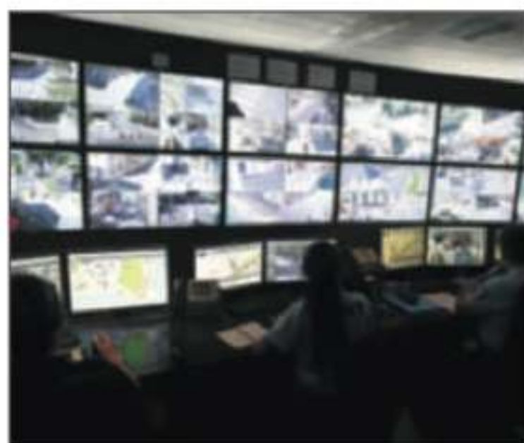
Le centre de supervision de la ville de Nice. (Photo Cyril Doderigny)
